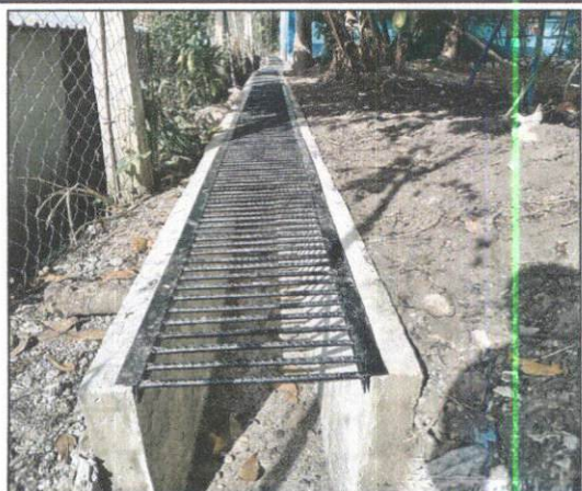
Foto 3: Cunetas con su respectiva rejilla mejorada.
