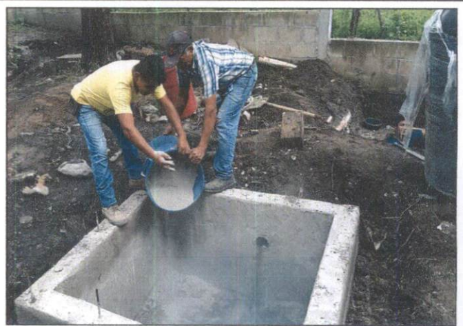
Foto 2: Tratamiento respectivo en fosa séptica a mejorar.
